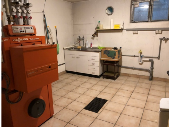
UG Heizraum / Waschküche
