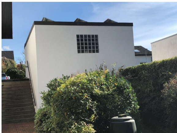
Doppelgarage Rückseite, Dach mit PV- Anlage
