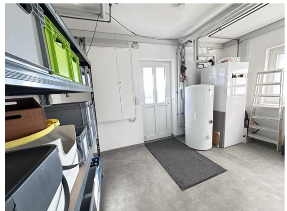
EG HWR u. Heizung
