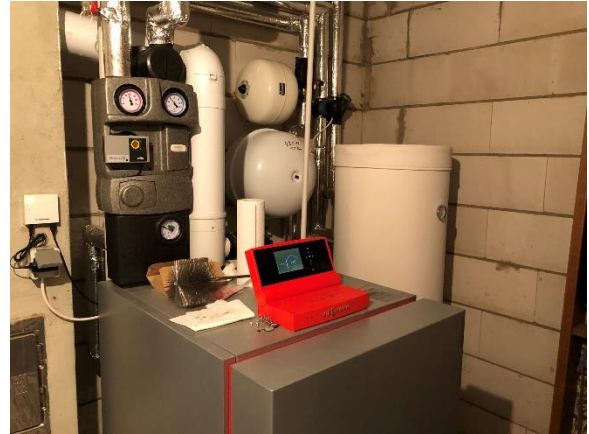
UG Heizanlage von 2017
