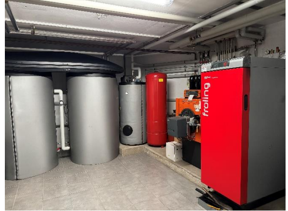
UG Heizanlage, Pufferspeicher
