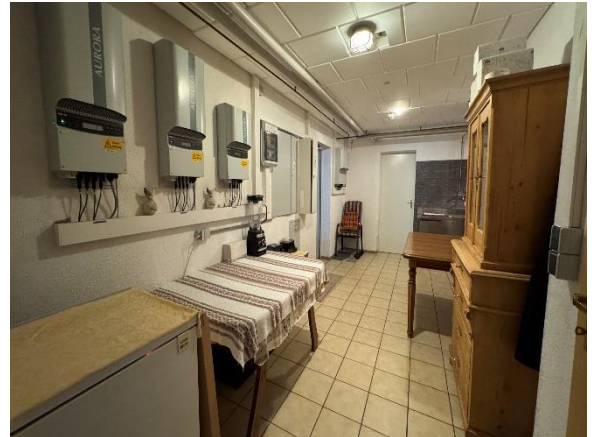
UG, PV Anlage
